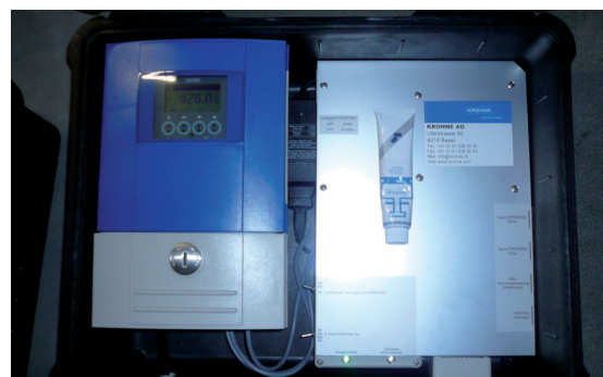
Convertisseur de mesure installé
