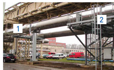
Zuleitung mit Strömungsgleichrichter (1) und Durchflussmessgerät (2)
