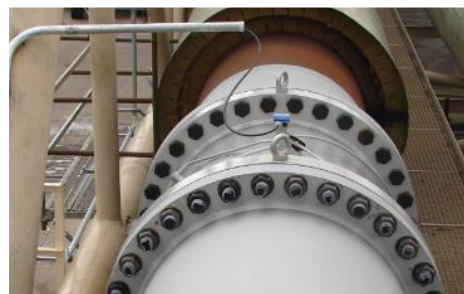
Měření průtoku horké vody průtokoměrem OPTISONIC 3400
