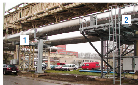
Přívodní větev s usměrňovačem průtoku (1) a průtokoměrem (2)
