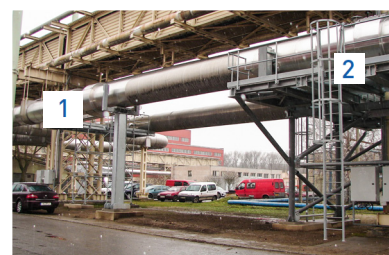
Ligne d'alimentation avec tranquilliseur d'écoulement (1) et débitmètre (2)
