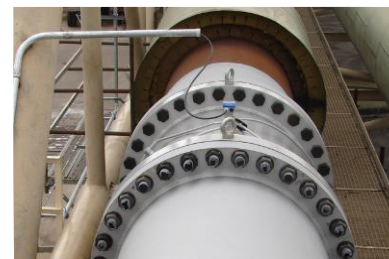
Mesure de débit d'eau chaude avec l'OPTISONIC 3400
