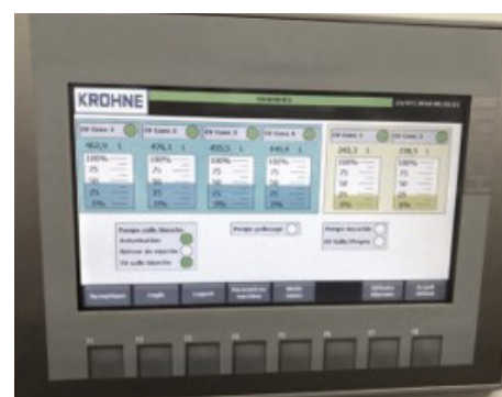
Surveillance de niveau via l'Automate Programmable Industriel
