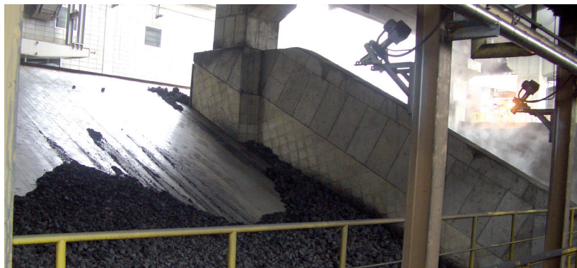
Contrôle de la trémie à coke
