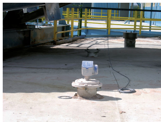
L'OPTIWAVE sur le silo de plâtre
