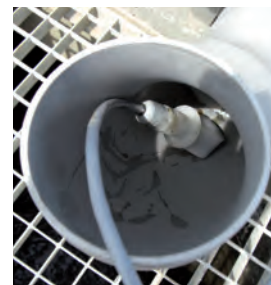
Equipo de referencia de medida de la conductividad línea abajo
