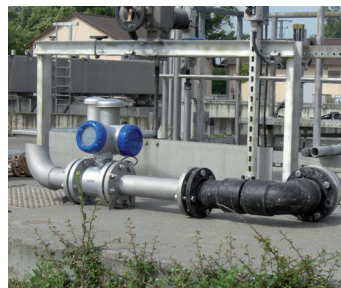
Испытательная установка на канализационных очистных сооружениях
