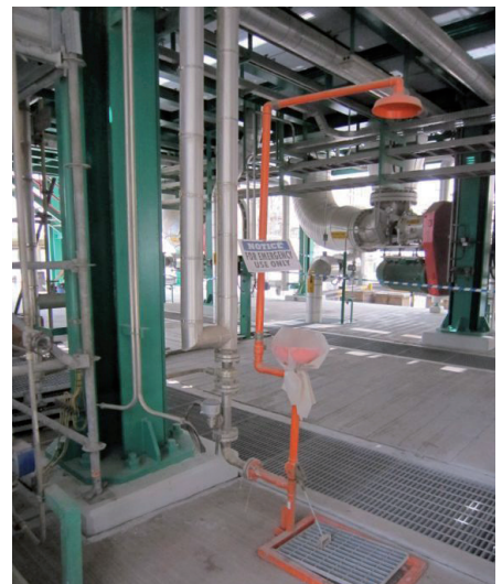
Douche de décontamination
