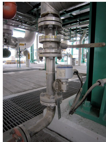
DW 182 EEx d installé sur une douche
