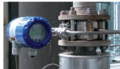
Труба для топливного газа
