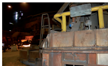
A droite : Appareils de mesure sur la trémie de remplissage
