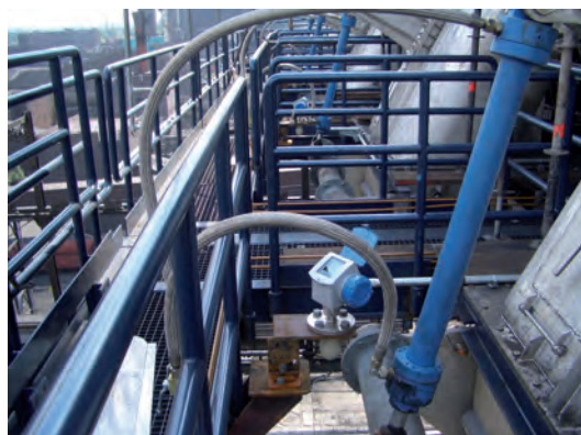
Четыре OPTIWAVE 6300 смонтированы непосредственно рядом с загрузочными рампами
