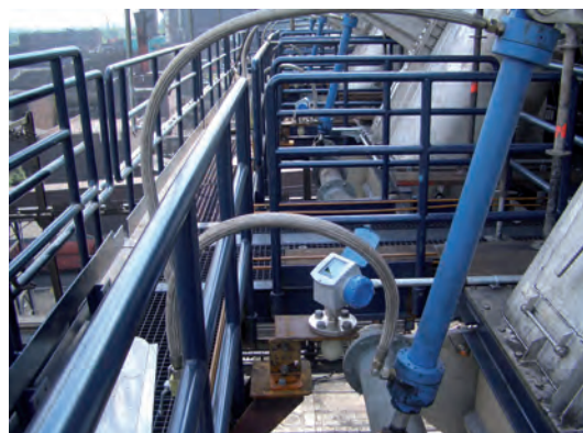
Quatre détecteurs OPTIWAVE 6300 sont installés directement à côté des rampes de chargement
