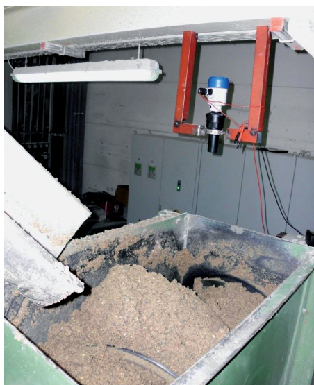
L'OPTISOUND 3010 au-dessus du mélangeur, avec l'une des vis visible.
