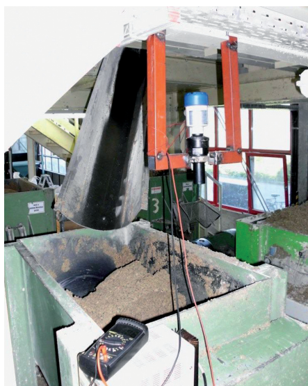
Remplissage automatisé : la goulotte de remplissage est visible en arrière plan.
