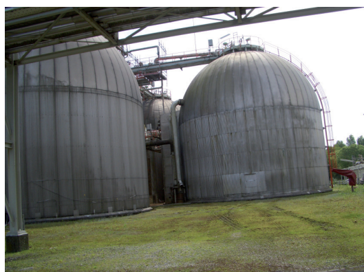
Die Chlorkugeln dürfen nur bis zu einer vorgegebenen Höhe befüllt werden
