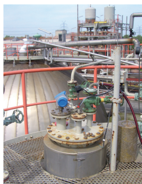
Auf dem Kugeldach: OPTIWAVE 7300 wurde auf den vorhandenen Flanschstützen installiert
