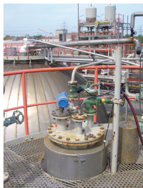
На крыше сферического резервуара: OPTIWAVE 7300 устанавливается на имеющиеся фланцевые присоединения
