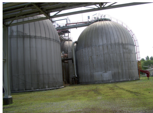
Les réservoirs sphériques de stockage de chlore ne peuvent être remplis que jusqu'à une hauteur prédéterminée
