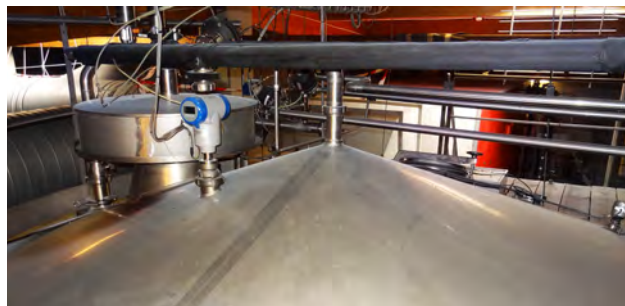
Transmetteur de niveau OPTIWAVE 5200 sur cuve d'eau purifiée
