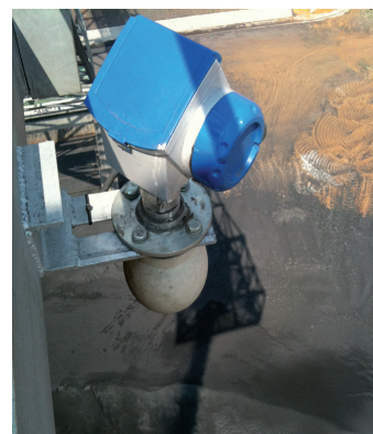
OPTIWAVE 6300 C, смонтированный на конвейере
