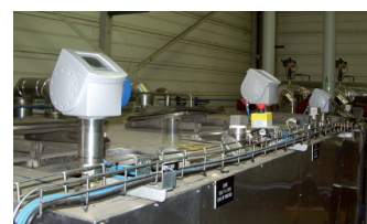
OPTIFLEX 1300 C sur réservoirs de stockage
