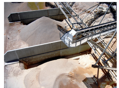
Convoyeur au-dessus de tas à ciel ouvert
