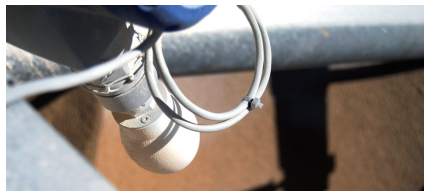
OPTIWAVE 6300 C con antena elipsoidal de PP DN 80 (3") instalado sobre una cinta transportadora con basculador para medir el nivel de un montículo
