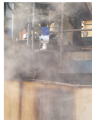
OPTIFLEX 1300 sobre un tanque de jugo de caña, en una atmósfera cargada de vapor
