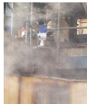
OPTIFLEX 1300 sur cuve de mélasse dans atmosphère chaude et humide
