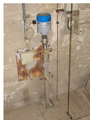
Montage dans un puits tranquillissant
