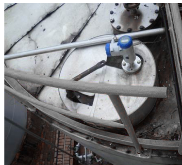
Уровень OPTIWAVE 5200 Ex d ia, установленный на патрубке резервуара
