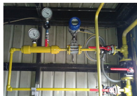
Вихревой расходомер, установленный в байпасном трубопроводе
