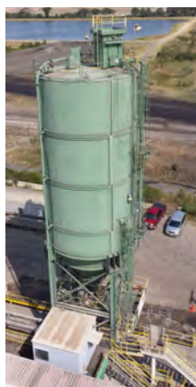
Резервуар с зольной пылью
