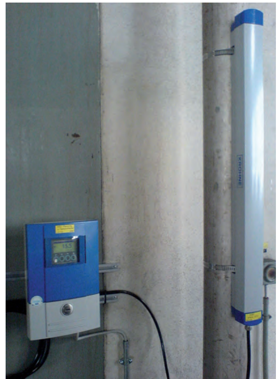
Durchflussmessung von demineralisiertem Wasser mit dem OPTISONIC 6300
