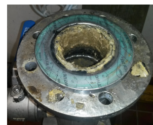
Трубопровод после коферментации с большими жировыми отложениями
