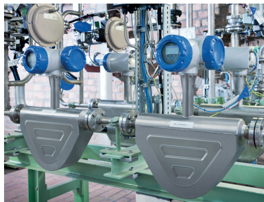
PLT-Sicherheitseinrichtung mit OPTIMASS 6400 in Reihe montiert
