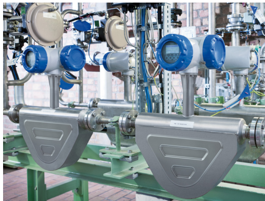
Equipo de seguridad PCT con OPTIMASS 6400 instalados en serie
