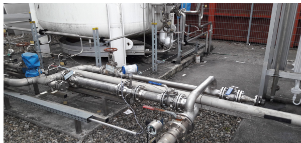
Stickstoffmessung hinter eingebautem Strömungsgleichrichter
