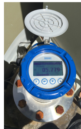
OPTIWAVE 6500 C, установленный наверху
