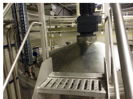
OPTIWAVE 3500 C, установленный наверху ёмкости
