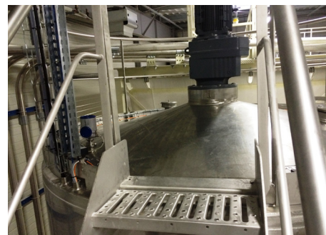
OPTIWAVE 3500 C installé au sommet du réservoir
