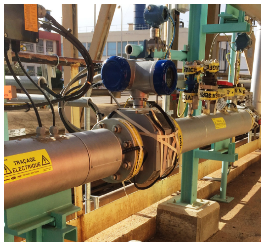
Коммерческий учет расхода с помощью ультразвукового расходомера газа ALTOSONIC V12
