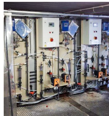
Nebeneinander installierte Chlormesssysteme
