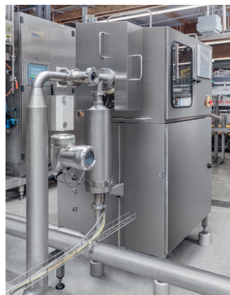
Sistema de dosificación para la esterilización en frío
