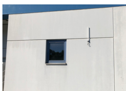
Antenne de l'unité de réception installée sur le bâtiment
