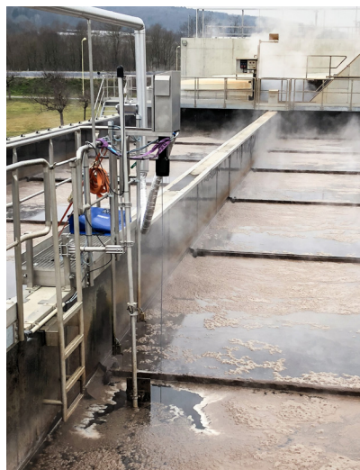
Mesure du voile de boues dans le décanteur
