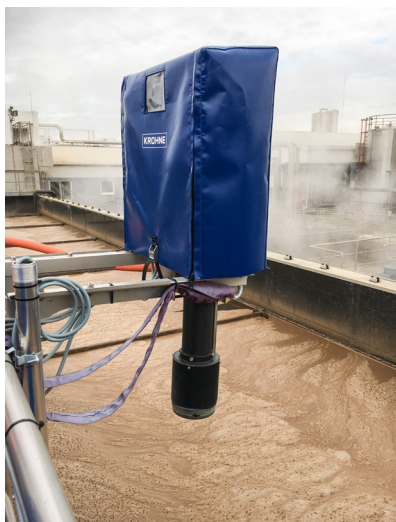
OPTISYS SLM 2100 mit Frostschutzhaube im Winterbetrieb
