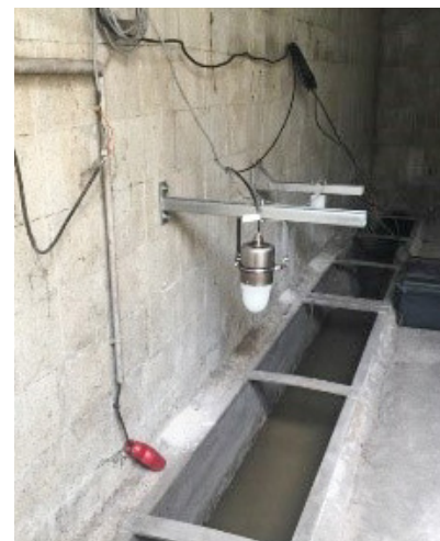
OPTIWAVE 1400 suspendido por encima del canal abierto
