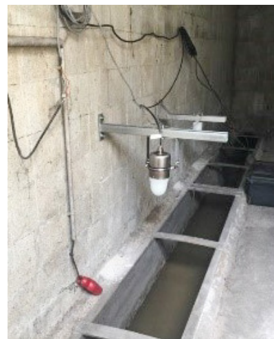
Un OPTIWAVE 1400 suspendu au-dessus du canal ouvert
