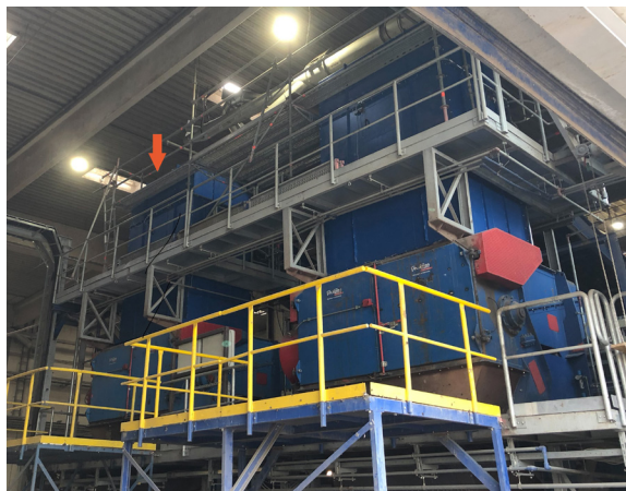
Réservoir de déchets avec mesure de l'OPTIWAVE 6500 (flèche rouge)
