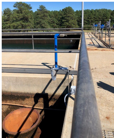
Radarové měření výšky hladiny ve vodní nádrži
