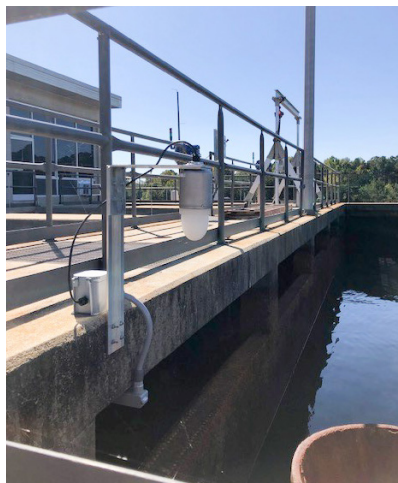
Radar na principu FMCW umístěný blízko přepadové trubky
