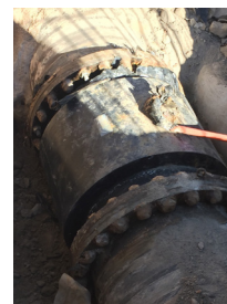
Поврежденный ЭМР до замены
