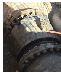
Poškozený přístroj před nahrazením
