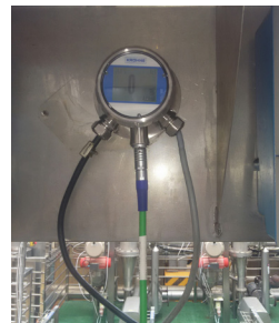
OPTISYS IND 8100 kurz nach der Inbetriebnahme
